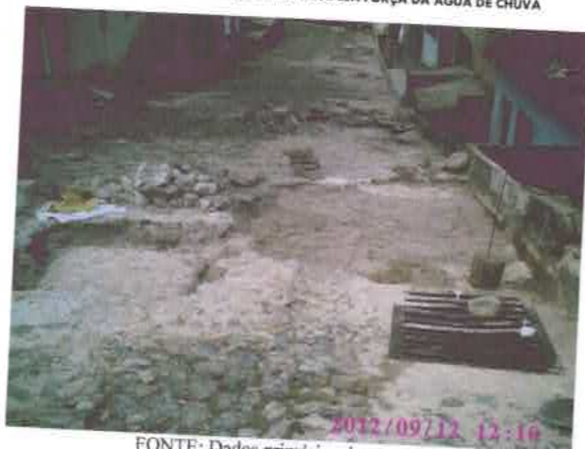
FIGURA 61 - PAVIMENTAÇÃO REMOVIDA PELA FORÇA DA AGUA DE CHUVA
